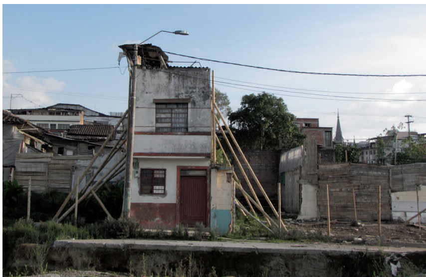
Fotografía No.5. Casa apuntalada con guadua en la Comuna San José. Fotografía: Fernando Cantor Amador
