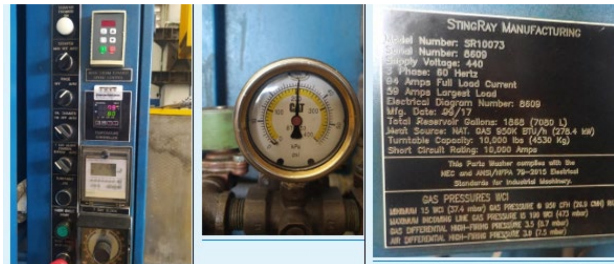
Figura 2. Equipos indicadores de temperatura (imagen de la izquierda), presión (imagen central) y placa de identificación
