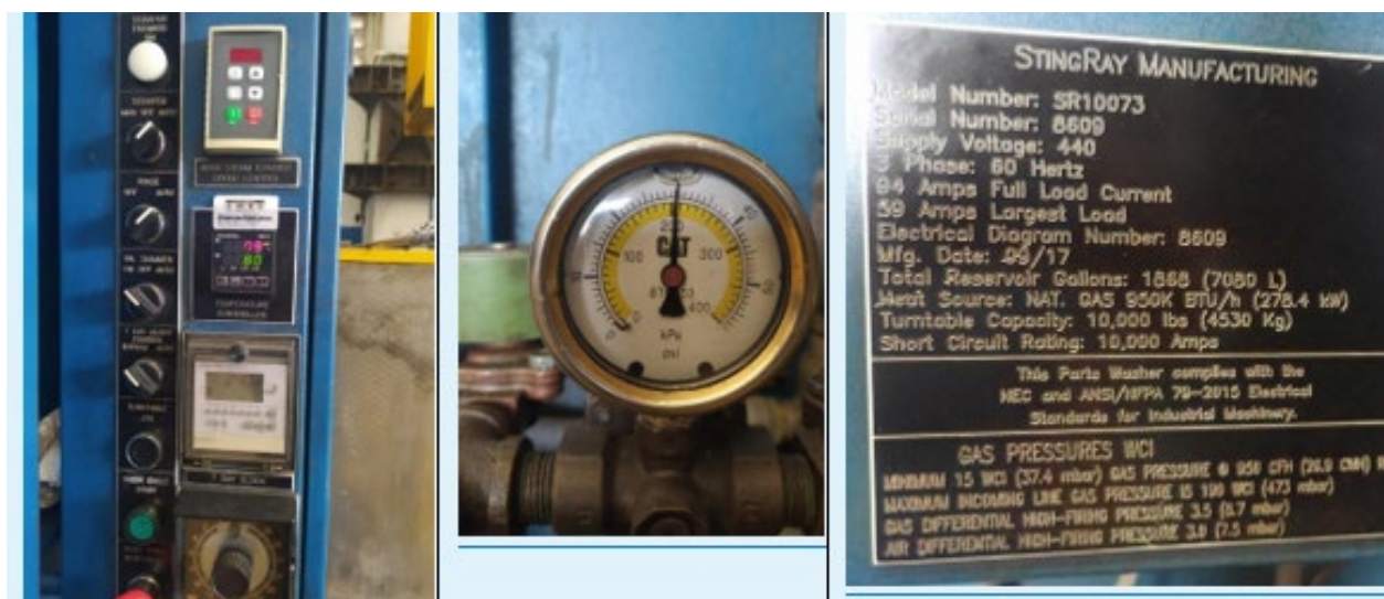
Figura 2. Equipos indicadores de temperatura (imagen de la izquierda), presión (imagen central) y placa de identificación
